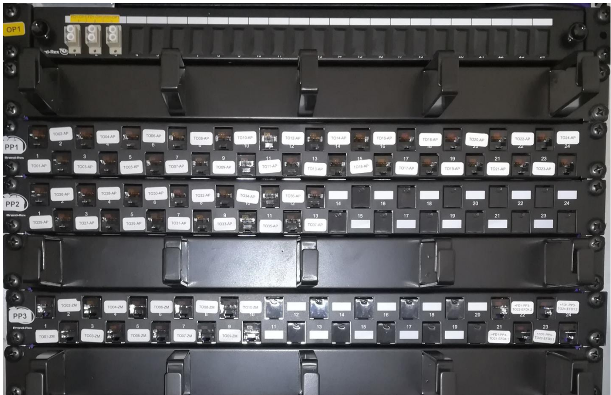
Slika 11. Primjer označivanja razdjelnika i panela
